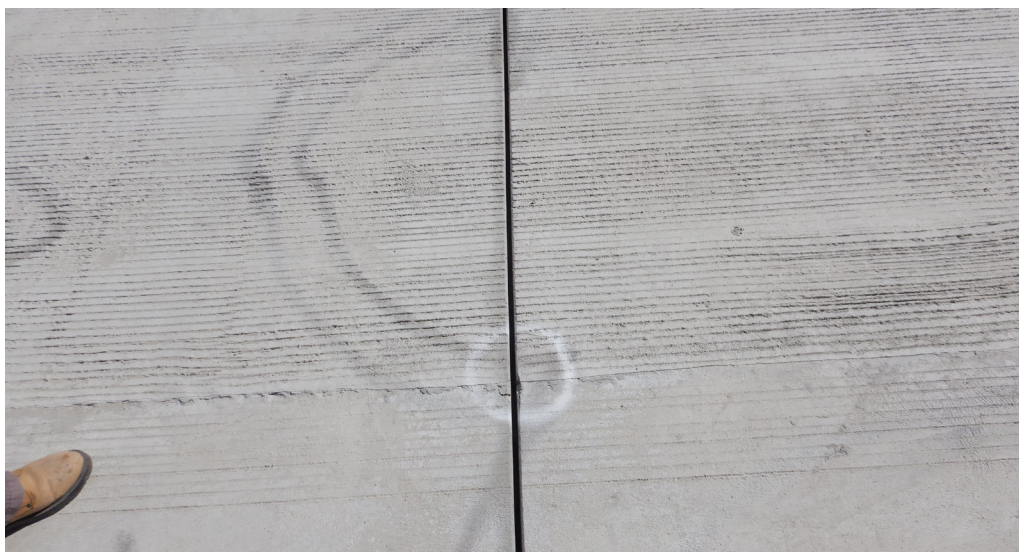
Photo A21.1 Ouvertures de réservoir non conformes de façon ponctuelle
