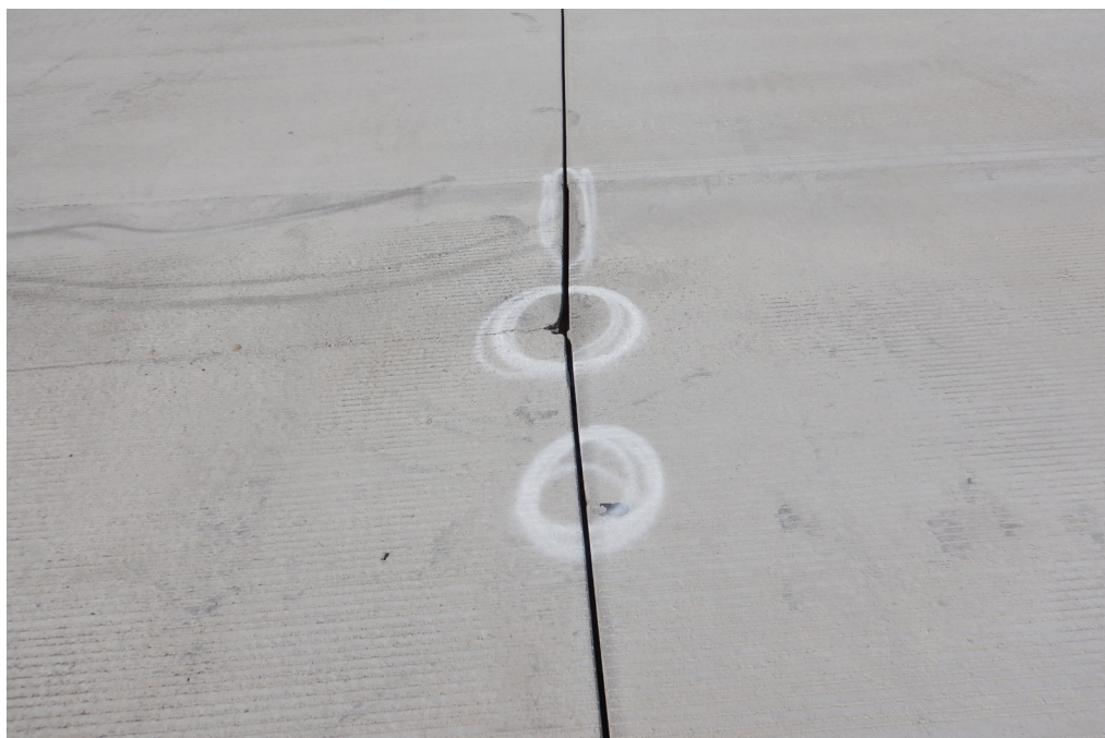
Photo A21.2 Ouvertures de réservoir non conformes de façon localisée (plusieurs à proximité)
